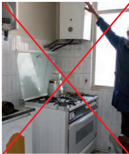
شکل ۱-۶ نصب نادرست آب گرم کن.
