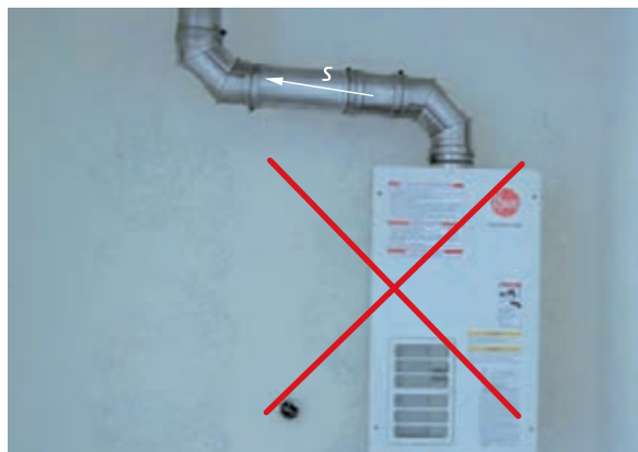
شکل ۱-۳۶ اتصال نادرست دودکش
