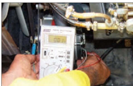
شکل ۳۰- آزمایش اجزای داخلی آلترناتور
