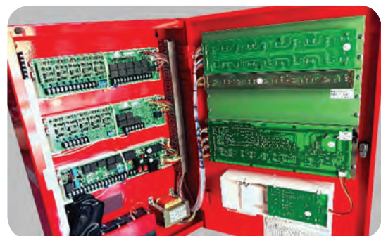
شکل ۳-۵۰- قسمت‌های مختلف نمای داخلی یک تابلوی کنترل مرکزی متعارف
