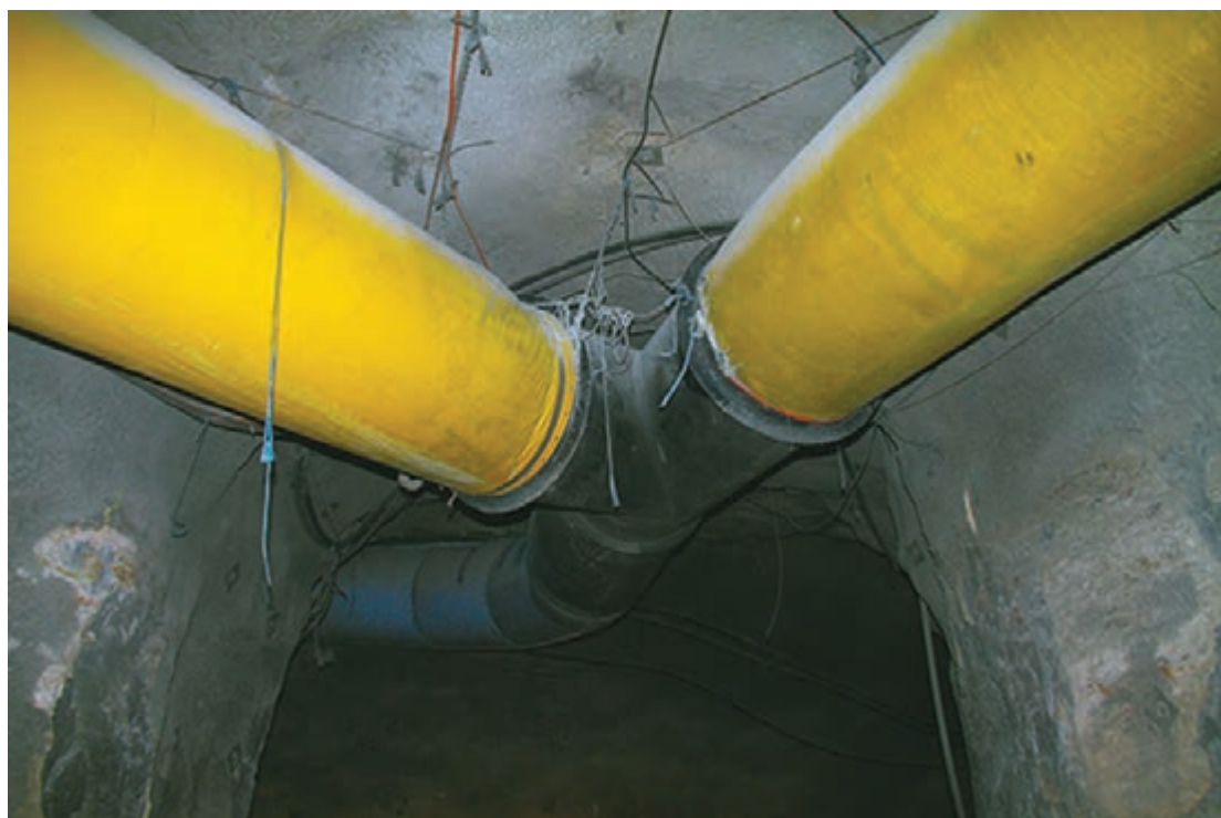
کانال‌های فلزی و برزنتی انتقال هوای معدن
