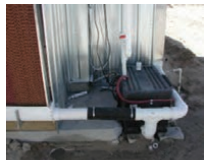
تصویر ۱۲-۲ - پمپ و لوله های توزیع آب
