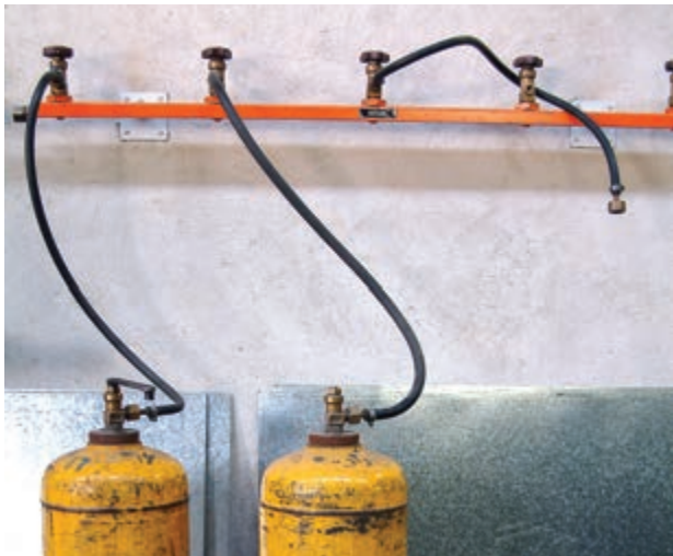
شکل ۲-۲۵- گاز استیلن از کپسول به خط لوله‌ی گاز هدایت می‌شود.
