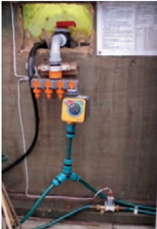
بخشی از سیستم آبیاری اتوماتیک
