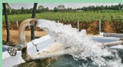
شکل ۱۶- لوله برگشت آب
