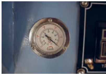
شکل ۴-۱۸- روشن کردن پمپ وکیوم
