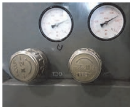
شکل ۴۲- شیر تنظیم مکش (شیر سمت چپ)
