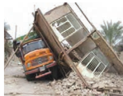
الف) ریزش دیوار در اثر زلزله
