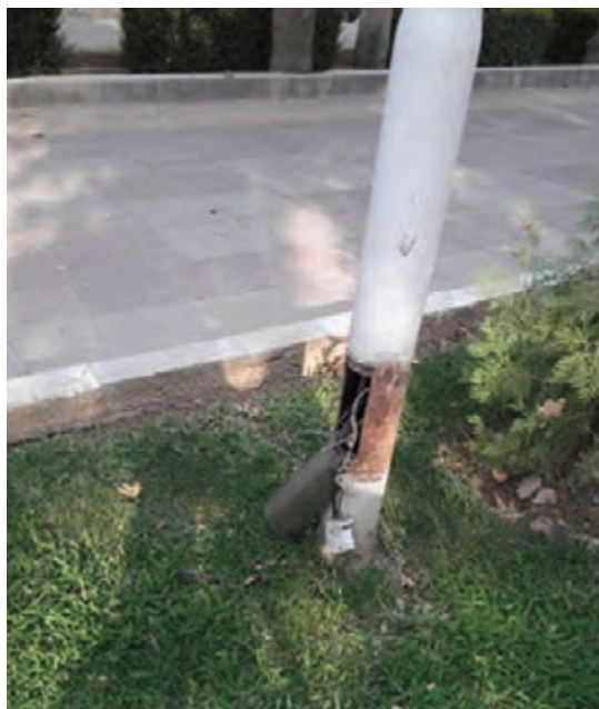
شکل ۲- وجود خرابی در سیستم برق کشی
