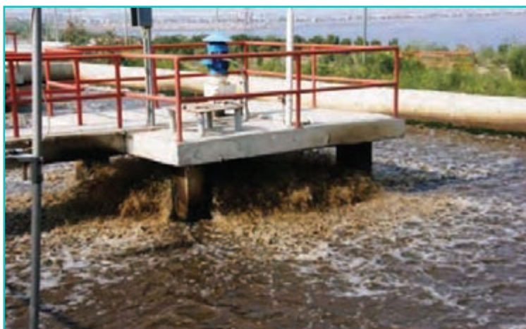
شکل ۵-۶- تصفیه‌خانه فاضلاب ارومیه
