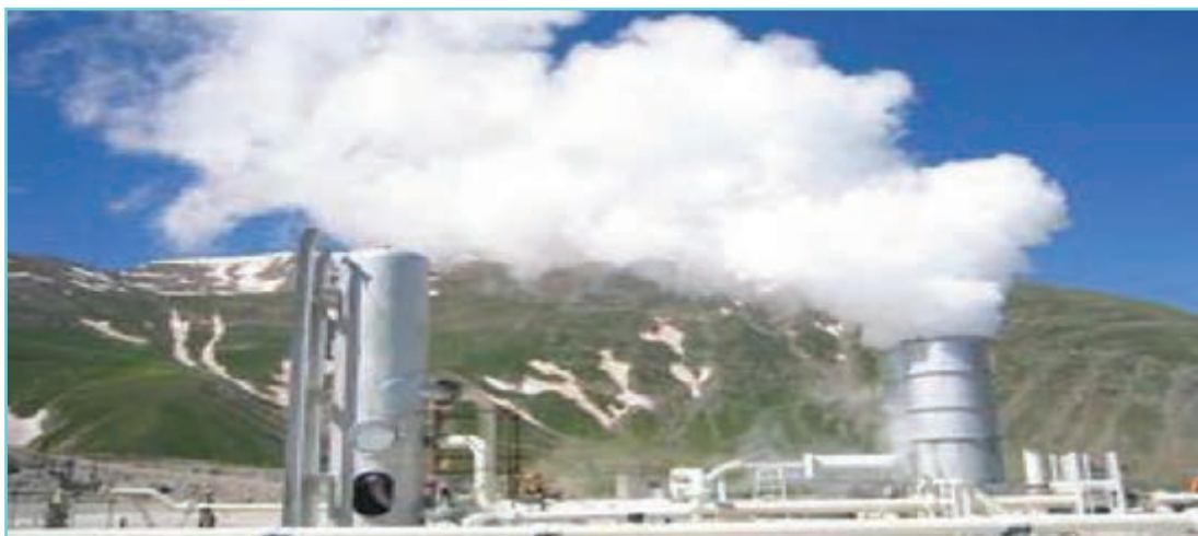
شکل ۲۴-۵- تأسیسات زمین گرمایی مشکین شهر
