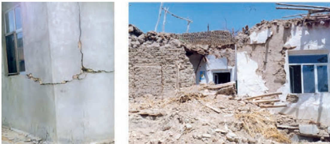
شکل ۳۶-۱- تصاویری از خسارت زلزله اردیبهشت ۱۳۸۱ در دینور
