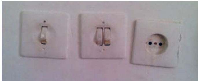
شکل ۱- نصب غلط کلید و پریز
