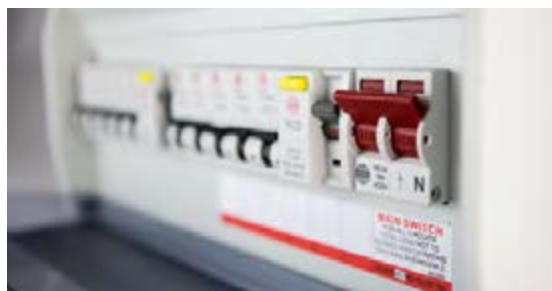
شکل ۷۹- تابلوی توزیع برق واحد مسکونی
