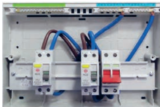
شکل ۴۷- سیم کشی قطعات تابلو
