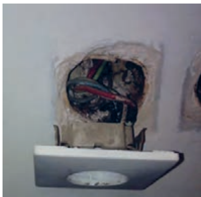
شکل ۳- قاب جداشده پریز از دیوار
