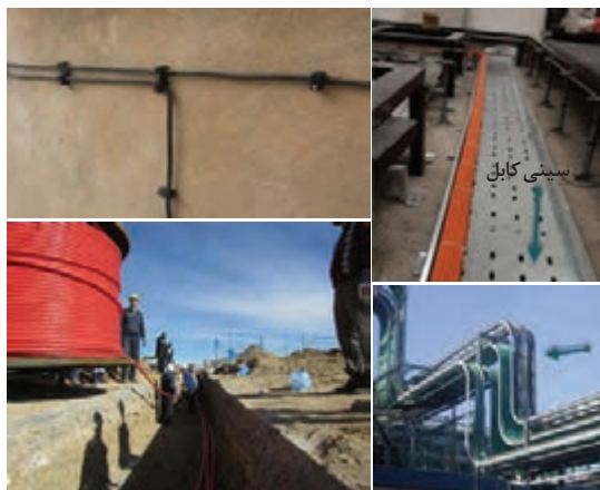
شکل ۱۹- انواع کابل کشی
