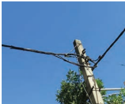
شکل ۲- کابل خود نگهدار
