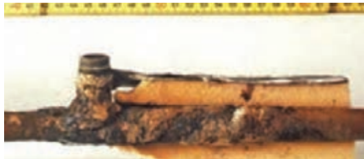
خوردگی موضعی لوله فولادی در زیر عایق حرارتی (پشم شیشه)
