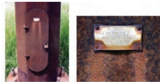
تشکیل پیل گالوانیک به دلیل نصب پلاک و قفل از جنس آلیاژ مس روی ستون فولاد کربنی
