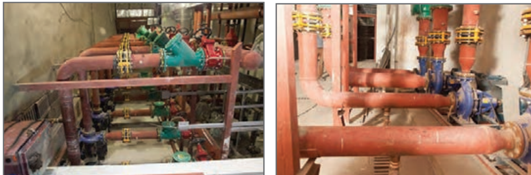
شکل ۳۳- خط مکش پمپ زمینی
