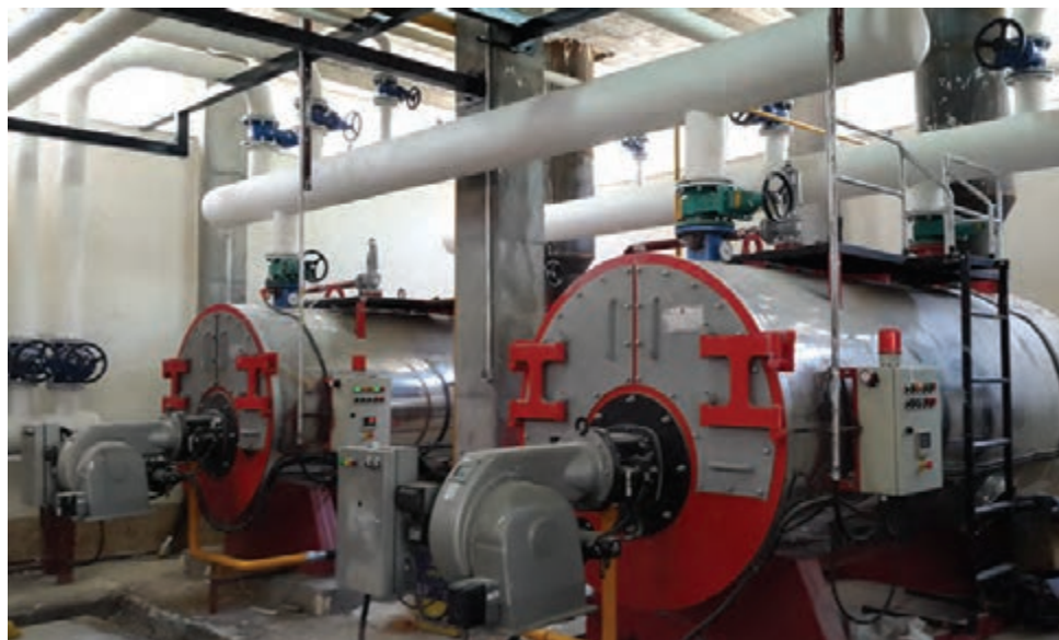
شکل ۲- نمایی از یک موتورخانه
