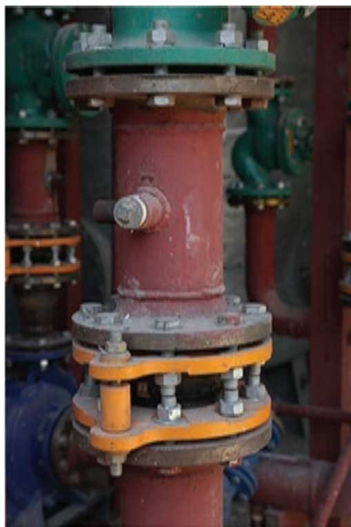
شکل ۲۰- ارتعاش گیر روی پمپ
