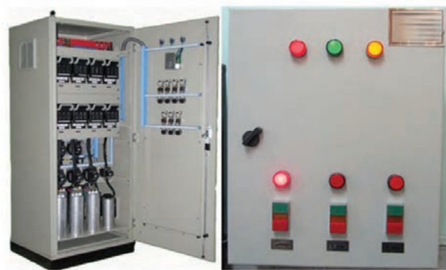
شکل ۴- تابلو برق ایستاده
