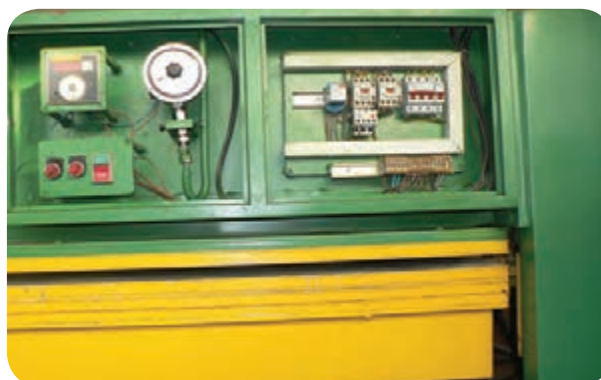
شکل ۸۴-۵- تابلوی فرعی برق نصب شده روی پرس
