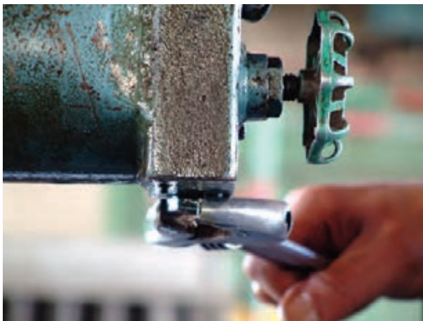
شکل ۱۴-۳ باز کردن درپوش تخلیه‌ی روغن
