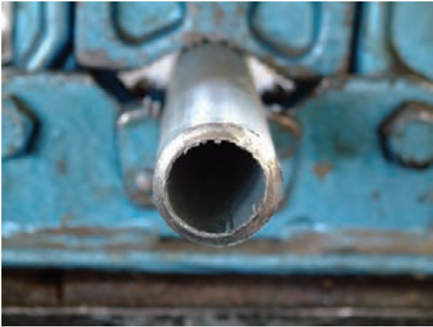
شکل ۲-۱۰- لوله‌ی برش خورده
