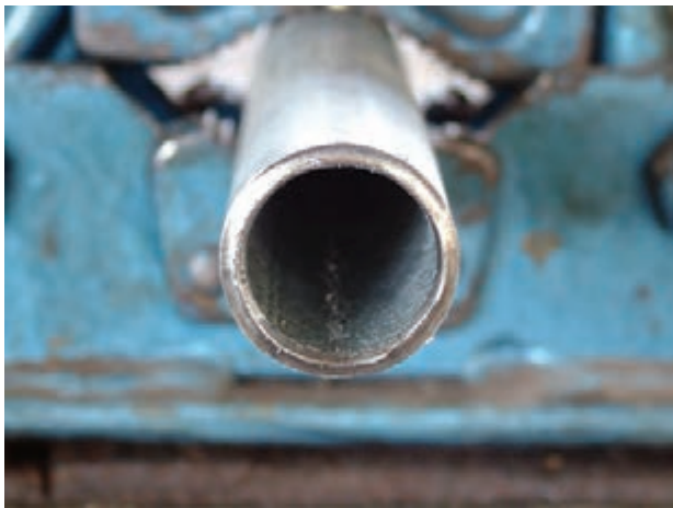
شکل ۲۰-۲- لوله‌ی برقو خورده
