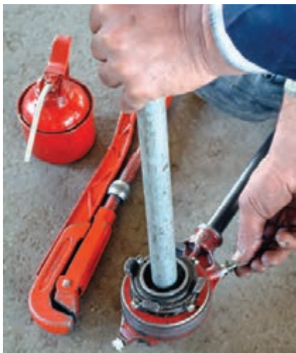
شکل ۱۱۸-۵- قرار دادن ضامن‌ها در جهت حدیده کردن و حرکت دادن لوله توأم با فشار در جهت دنده شدن لوله
