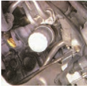
شکل (۲-۶۰) کنترل فیلتر از نظر نشتی
