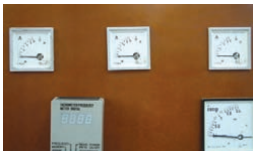
شکل ۱۱-۶- آمپرمترهای اندازه‌گیری جریان فازها
