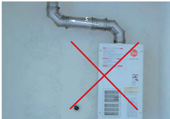
شکل ۱-۳۶ اتصال نادرست دودکش
