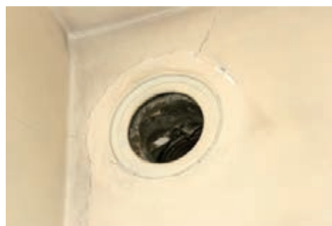
شکل ۱-۴ دودکش در محل نصب آب گرم کن.
