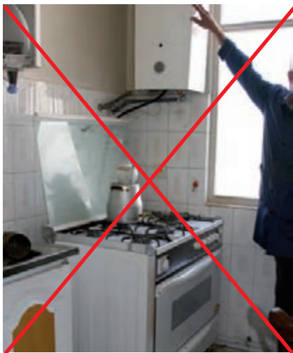
شکل ۱-۶ نصب نادرست آب گرم کن.
