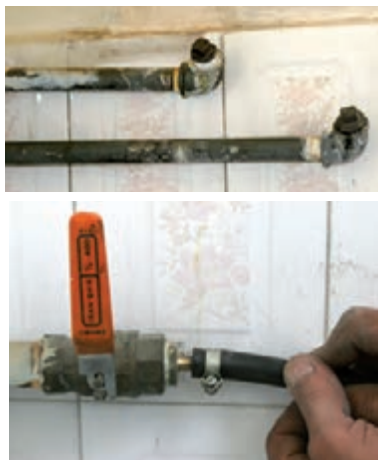
شکل ۱-۵ لوله‌های آب سرد، آب گرم و شیلنگ گاز در محل نصب آب گرم کن.
