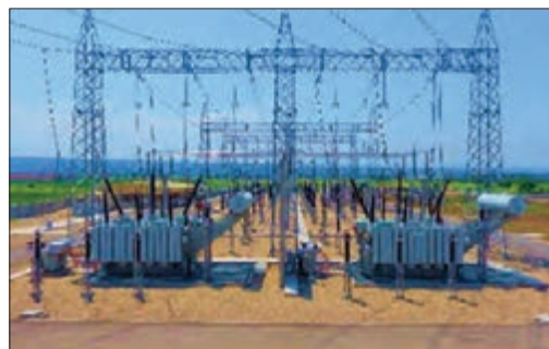
شکل ۳- پست تقویت ولتاژ
