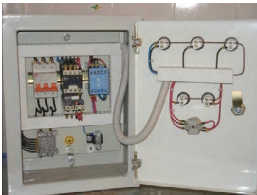
شکل ۱۴- تابلو راه اندازی موتور الکتریکی سه فاز به صورت دائم
