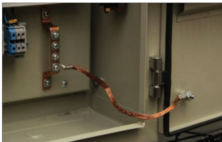
شکل ۹۲- صفحه نصب در داخل تابلو
