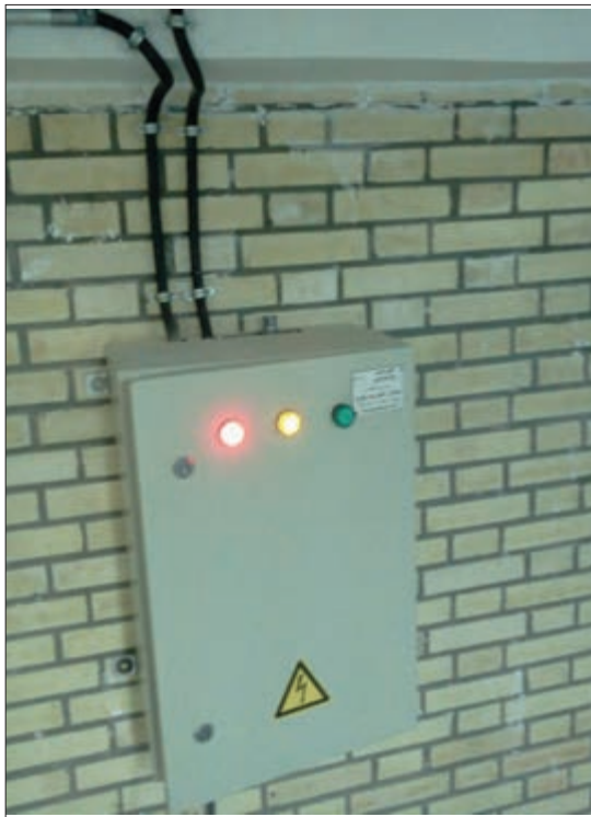
شکل ۲۰- مسیر ورود و خروج کابل‌ها در تابلو
