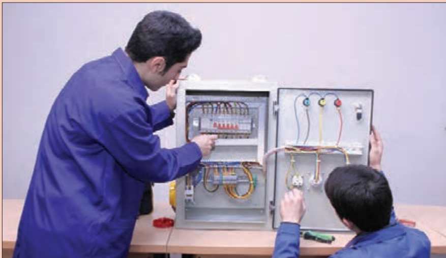
شکل ۳۰- قطعات الکتریکی و غیر الکتریکی تابلو برق
