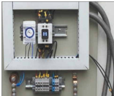
شکل ۱۰۷- محل نصب تایمر ۲۴ ساعت در تابلو روشنایی
