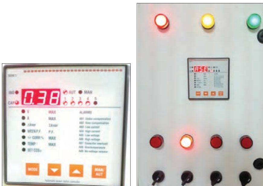
شکل ۲۱- روند شناسایی اتوماتیک توسط رگولاتور شکل ۲۲- نتیجه عملکرد رگولاتور اصلاح ضریب توان
