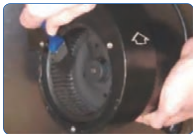
تمیزکردن فن مشعل از گردوغبار
