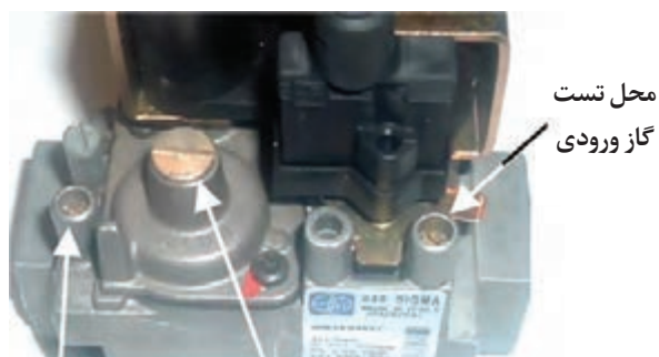
در زیر این درپوش پیچ تنظیم فشار گاز تزریقی است محل تست فشار گاز تزریقی
