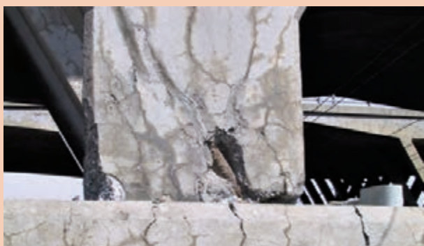
شکل ۱۰- ترک خوردگی بتن در اثر حمله یون سولفات
