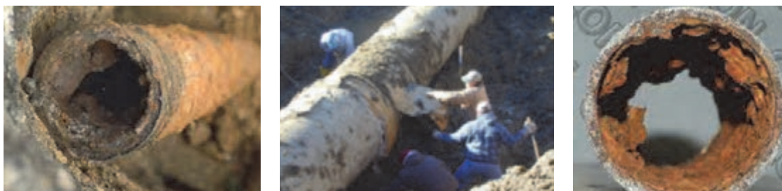
شکل ۴- نمونه‌ای از خوردگی لوله‌های دفن شده
