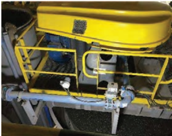
شکل ۲۷- سیستم کنترل هوا
