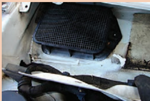
شکل ۲۰- اثر گرفتگی مجرا و عدم تخلیه آب
