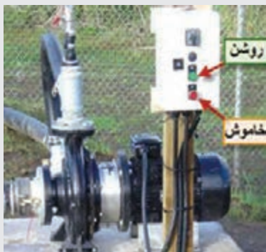
شکل ۲۰- کلیدهای کنترل روی تابلو
