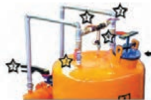
۱ و ۲- شیرهای برگشت (By pass)، ۳ و ۴- شیرهای ورودی و خروجی مخزن ۵- شیر فلکه روی لوله اصلی
