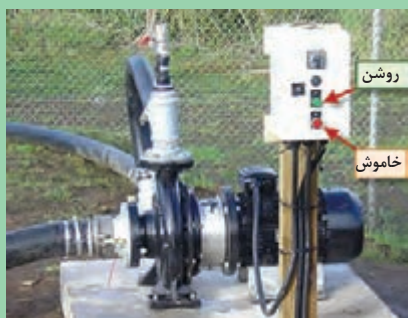
شکل ۱۴- کلیدهای کنترل روی تابلو
