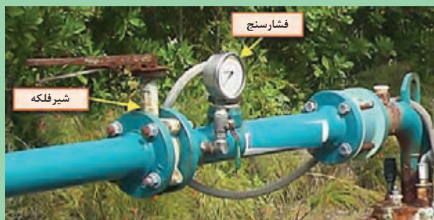
شکل ۱۳- محل شیرفلکه و فشارسنج روی لوله رانش
