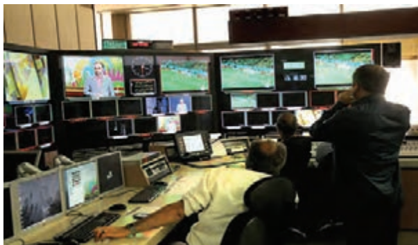
تصویر ۲۹- اتاق فرمان کنترل پخش
