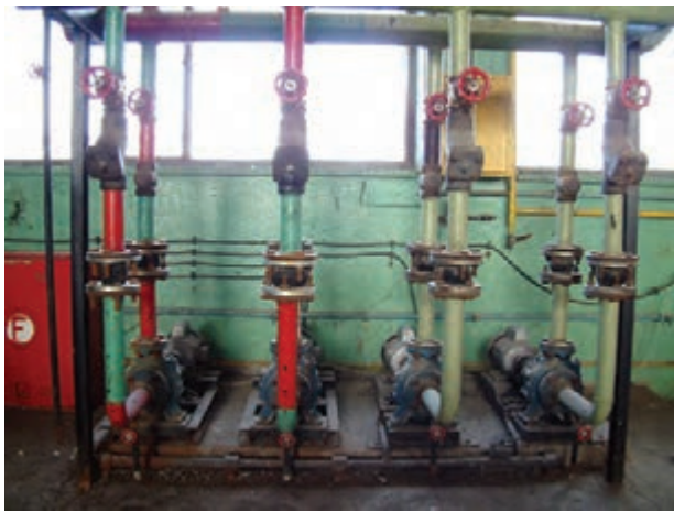
شکل ۳۱-۵- استفاده از اتصال فلنجی برای نصب پمپ‌های زمینی در تهویه مطبوع
