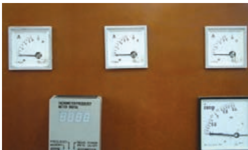
شکل ۱۱-۶- آمپرمترهای اندازه‌گیری جریان فازها
