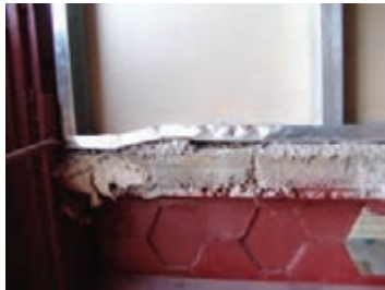
شکل ۷۱-۱- اجرای نامناسب رانر بر روی کف سازه‌ای
