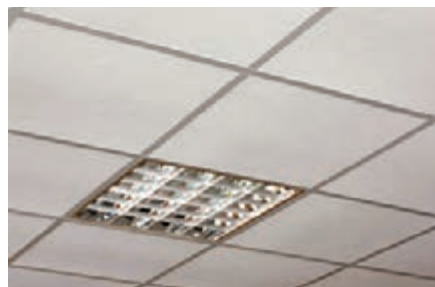
شکل ۳-۴- سقف کاذب مشبک
