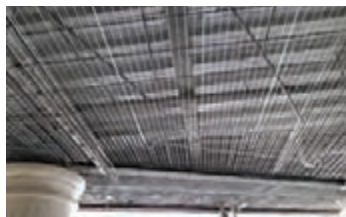
شکل ۳-۲- سقف کاذب رابیتس
