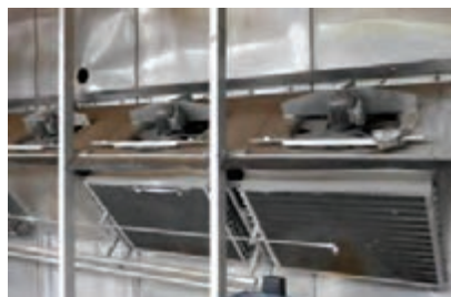
شکل ۴۰- انتقال حرارت کویل‌ها به وسیله فن‌ها
