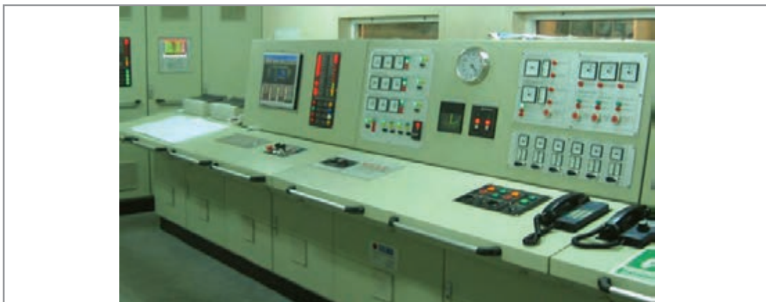
شکل ۴۰ - سامانه هشدار اتاق کنترل موتورخانه
