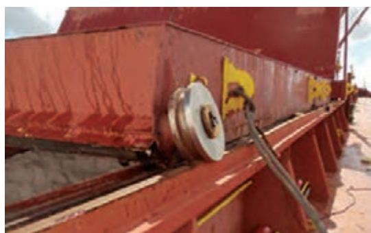
شکل ۳- در یک انبار که چرخ‌های آن خراب شده است.
