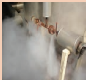
نشتی از اتصال در خط لوله
