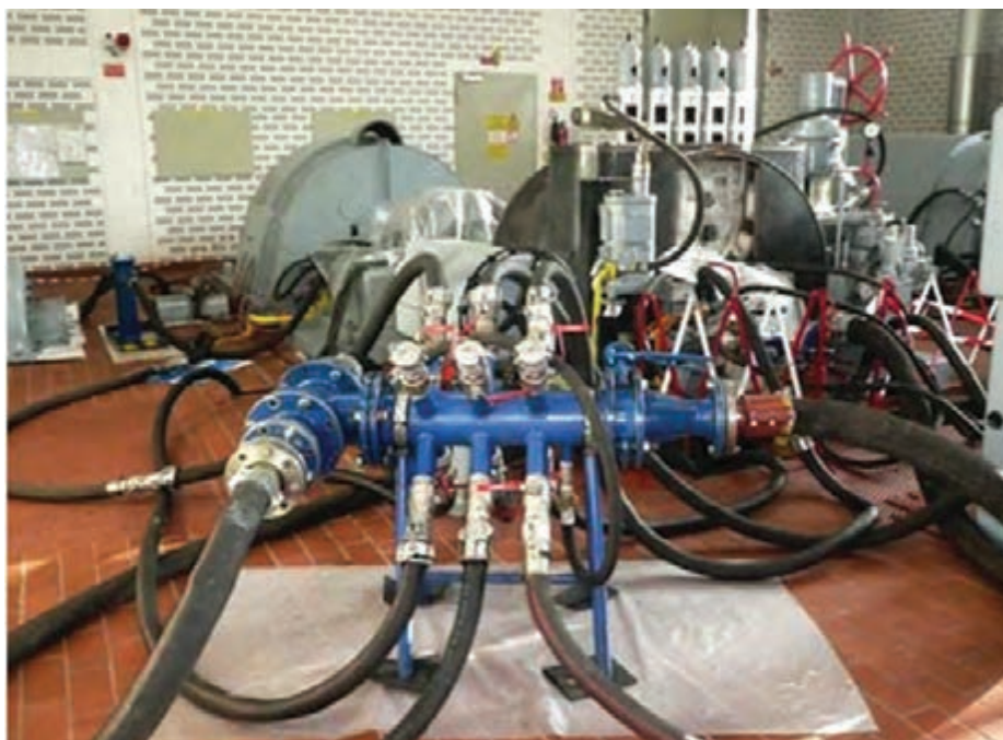
شکل ۲۳- سامانه تمیزکاری کمپرسور
