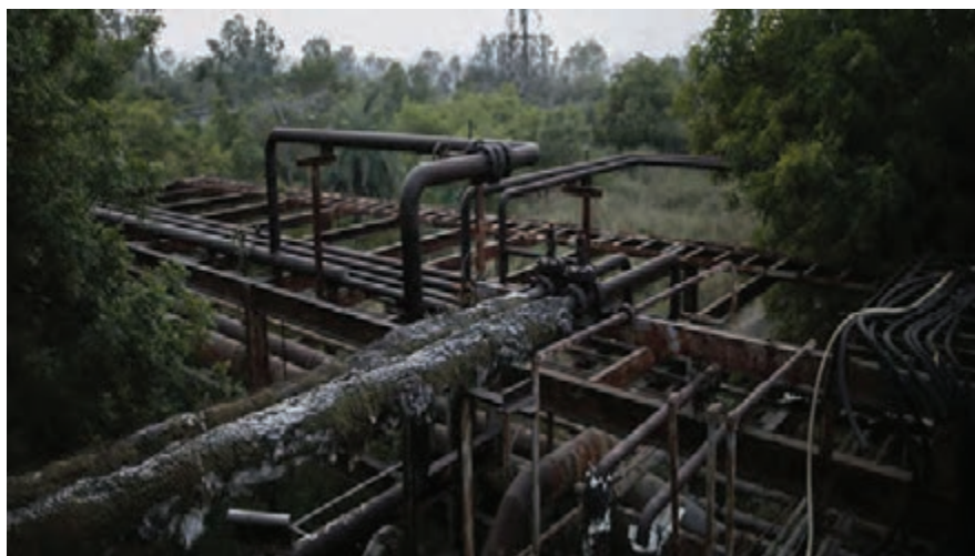
شکل ۷- خطوط لوله آسیب دیده در کارخانه یونیون کارباید
