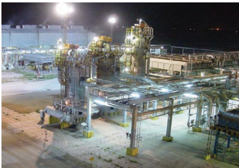
شکل ۳۲-۵ کارخانه گاز و گاز مایع شماره ۹۰۰- اهواز
