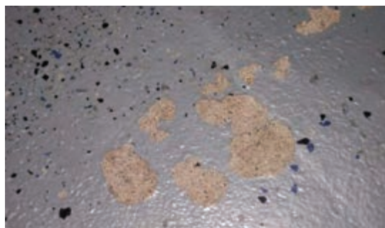
شکل ۱۱۴- وجود حباب در سطح کفپوش اپوکسی
