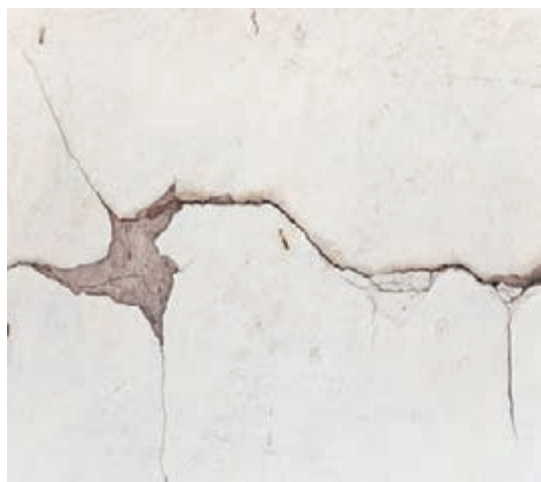
شکل ۱۰۲- ترک و پوسیدگی سطح دیوار
