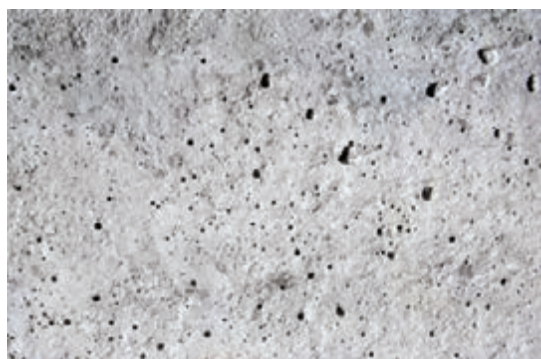
شکل ۱۱۵- وجود حفره در سطح بتن
