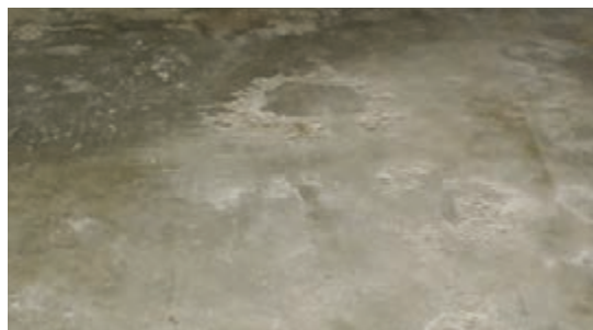
شکل ۱۱۷- رطوبت در بتن قابل رؤیت است
