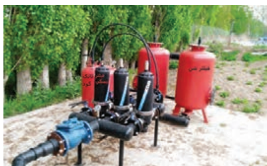
شکل ۳۶- ایستگاه کنترل مرکزی
