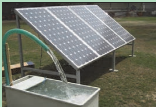
شکل ۳۸- کاربرد سامانه فتوولتاییک در پمپ چاه آب
