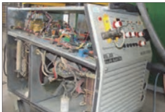
شکل ۱۱- ساختمان داخلی رکتیفایر
