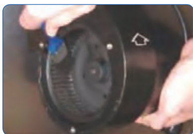
تمیزکردن فن مشعل از گردوغبار
