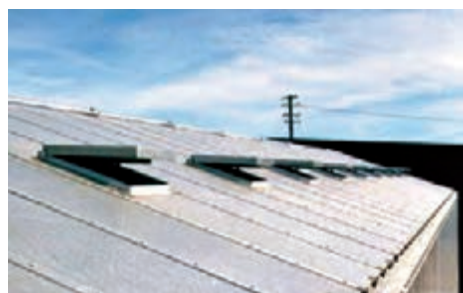
شکل ۴۴- دریچه‌های تخلیه هوا
