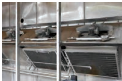
شکل ۴۰- انتقال حرارت کویل‌ها به وسیله فن‌ها
