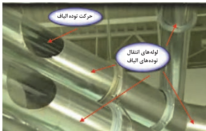
شکل ۸- لوله‌های انتقال الیاف در سیستم شوت فید
