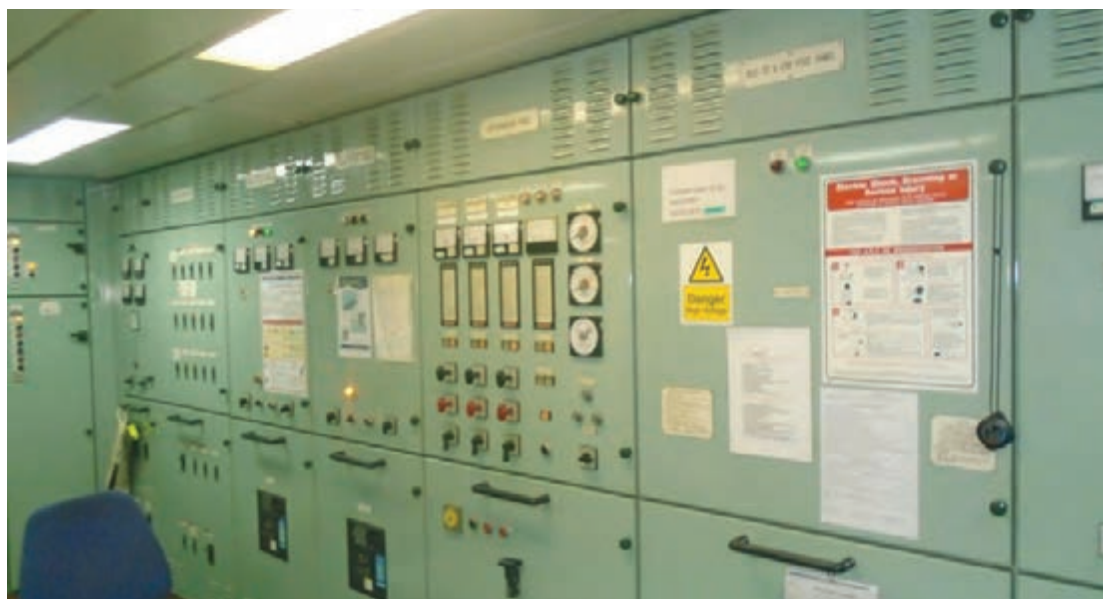
شکل ۲۳- تابلوی اصلی برق شناور
