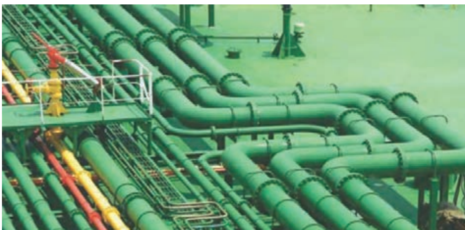
شکل ۲۹- سامانه لوله‌کشی روی عرشه یک نفتکش
