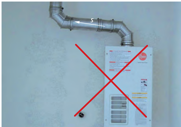
شکل ۱-۳۶ اتصال نادرست دودکش
