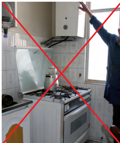
شکل ۱-۶ نصب نادرست آب گرم کن.
