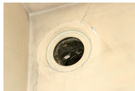
شکل ۱-۴ دودکش در محل نصب آب گرم کن.
